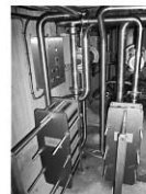
Thermes de Bagnols-les-bains (48) Réalisation Roussel Inox
