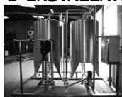
Usine d'embouteillage d'eau minérale (Géorgie) Réalisation T.T.I.A.G
